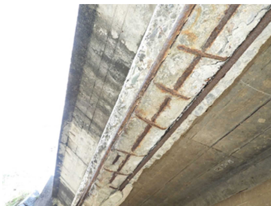
(コンクリート桁の剥離・鉄筋露出)
