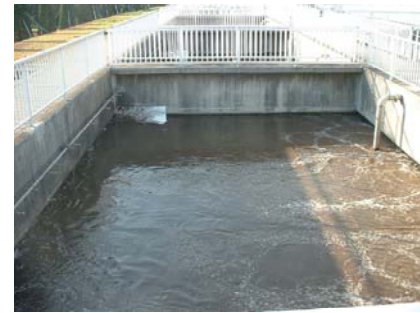
反応タンク (標準活性汚泥法)
