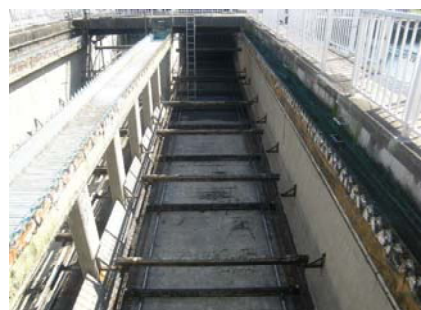
最終沈澱池 (内部)
