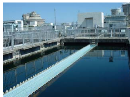
Tanque de sedimentación final
