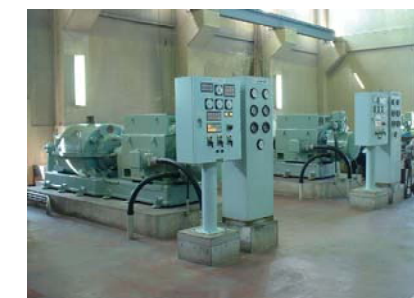
Sistemas de ventilación
