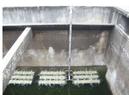
Tanque de reacción (difusor)
