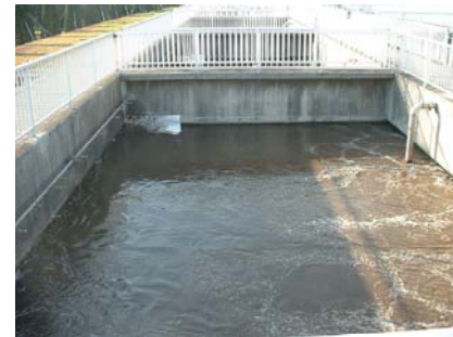
Tanque de reacción (Proceso de lodos activados estándar)
