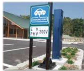
■しまなみアースランドの充電設備
