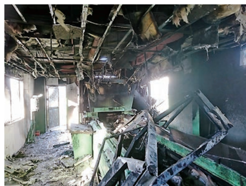
リサイクルセンターの火災状況
