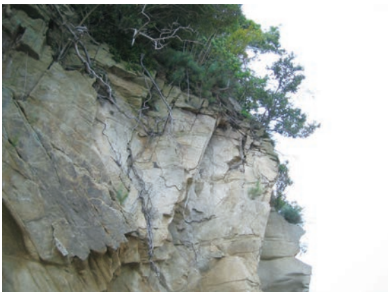
根の侵入による崖の崩落
