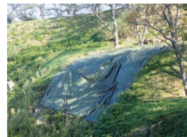
豪雨災害の被害状況
