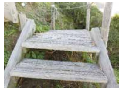
木製階段（郭II～郭V）の破損状況
