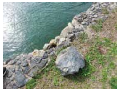
南部平坦地の石積の破損状況
