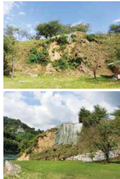
豪雨災害の被害状況
