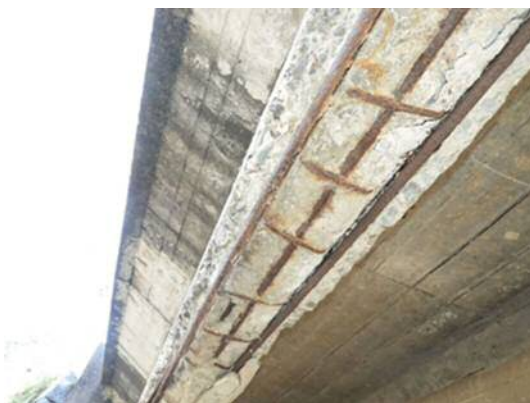
(コンクリート桁の剥離・鉄筋露出)
