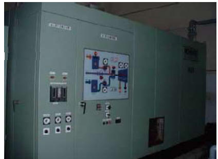
汚泥棟と遠心脱水機
