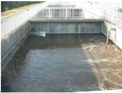
反応タンク（標準活性汚泥法）
