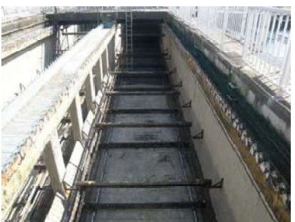
最終沈澱池（内部）
