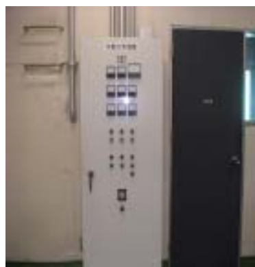
炉動力制御盤
