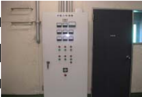
炉動力制御盤
