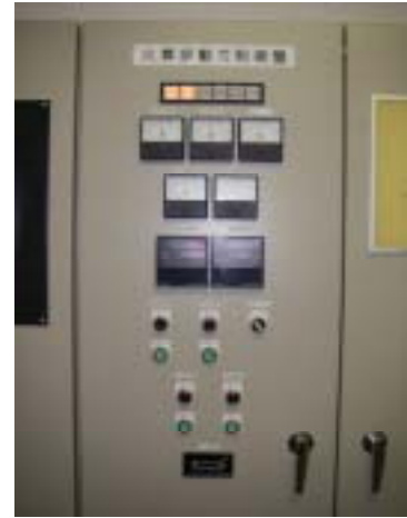
火葬炉動力制御盤
