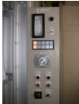
火葬炉手元操作盤
