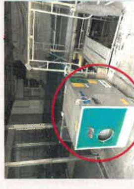
集塵機を設置し室内の換気を実施
