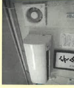
扇風機や換気扇とエアコンを併用
