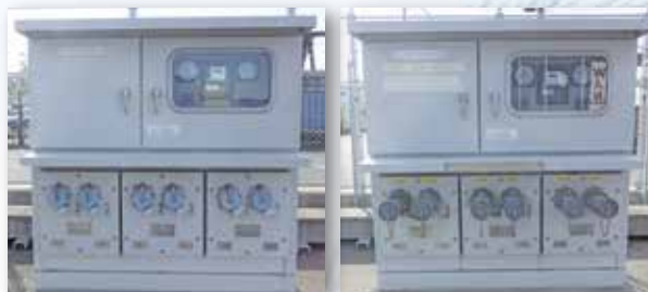
H7.H15年設置 Installed in 1995 and 2003
