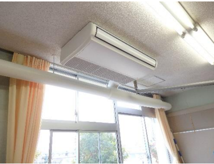
【空調室内機(普通教室)】
