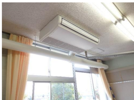
【空調室内機(普通教室)】
