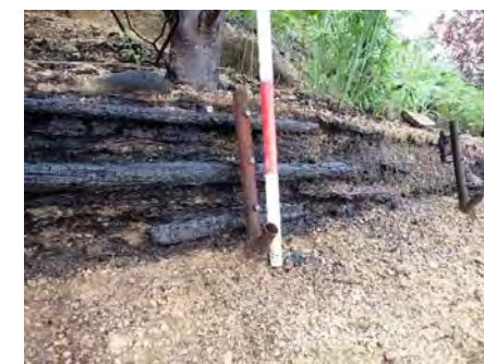
笠松山 筋工焼損状況
