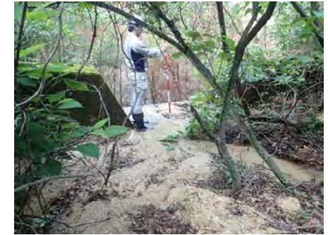
谷止工25(昭和63年施工) 堆砂状況(満砂)
