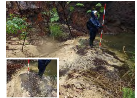
谷止工6(2)(平成20年施工) 堆砂状況(表面に灰の堆積)
