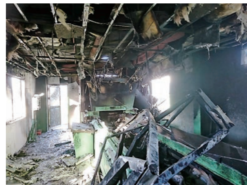
リサイクルセンターの火災状況
