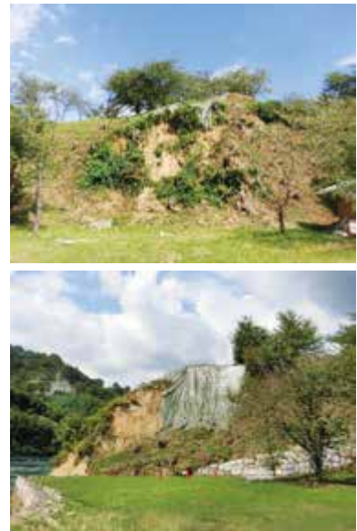
豪雨災害の被害状況
