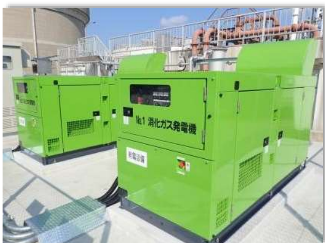
今治市下水浄化センターの消化ガス発電設備
