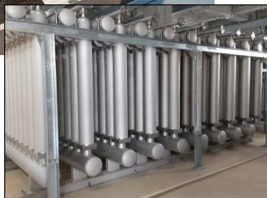
（高橋浄水場 膜ろ過設備）
