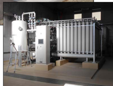
（桜井浄水場 膜ろ過設備）
