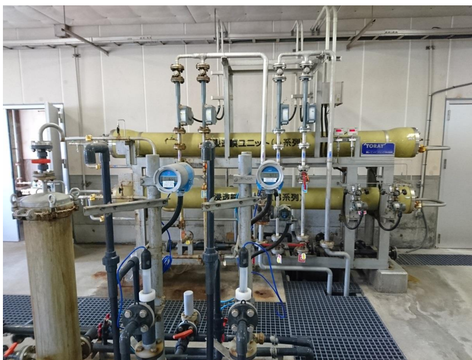
(今治市関前大下浄水場逆浸透モジュール)
